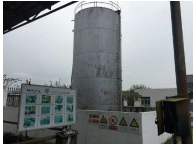
柴油储罐区标识
