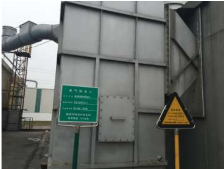
废气治理设施标识
